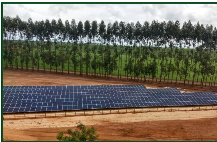
Placas solares para geração de energia.
